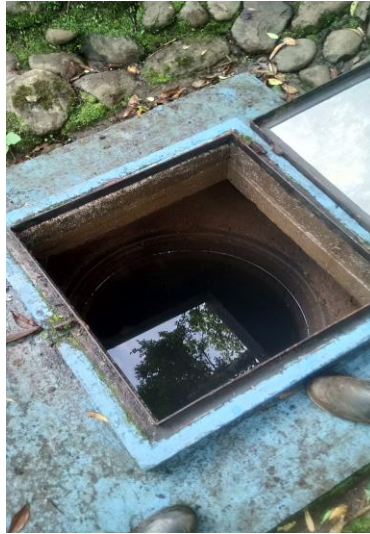
Figura 3: Vista de la captación.
