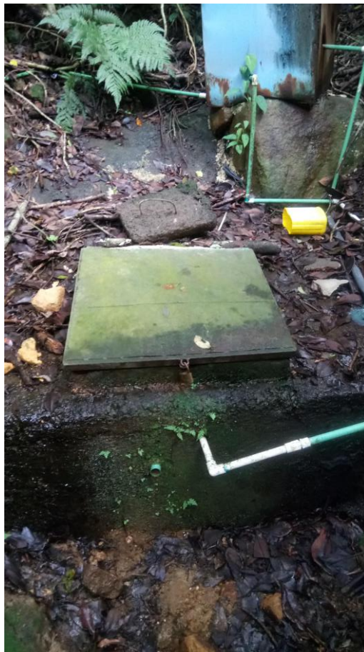
Figura 2: Captación Manantial Belén.
