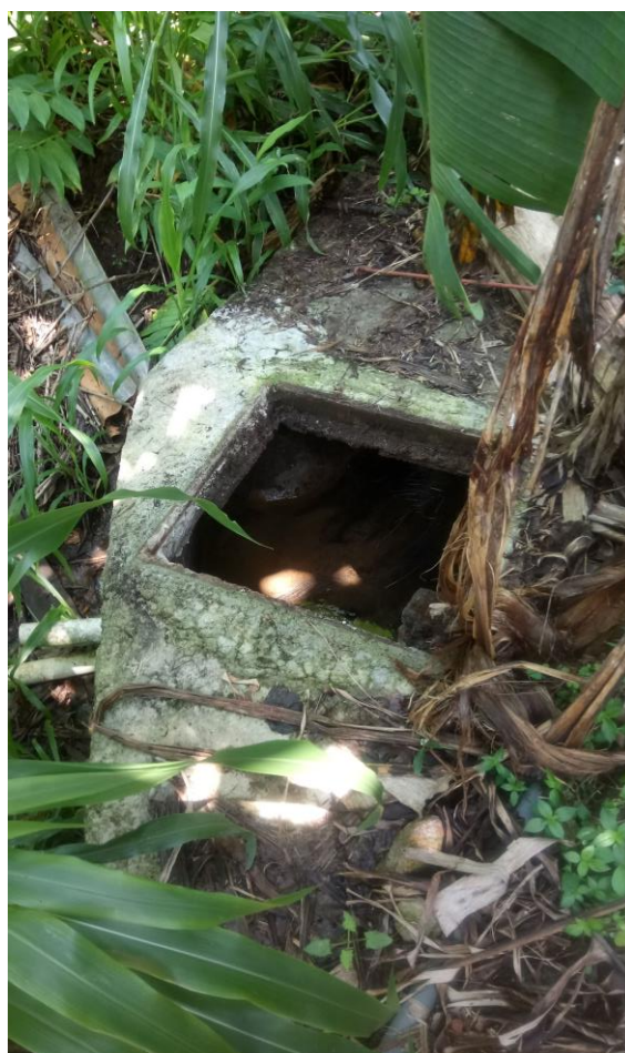
Figura 13: Captación Manantial Francisco Montero.
