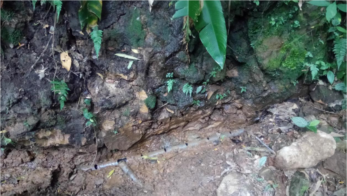
Figura 12: Captación del manantial.
