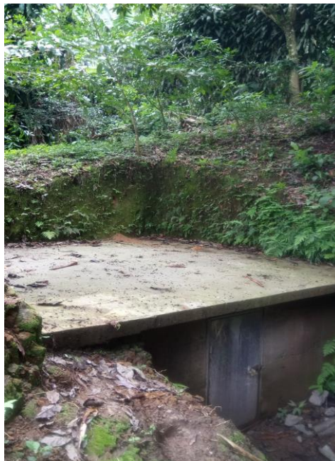
Figura 13: Captación Manantial Bajo Barrantes.
