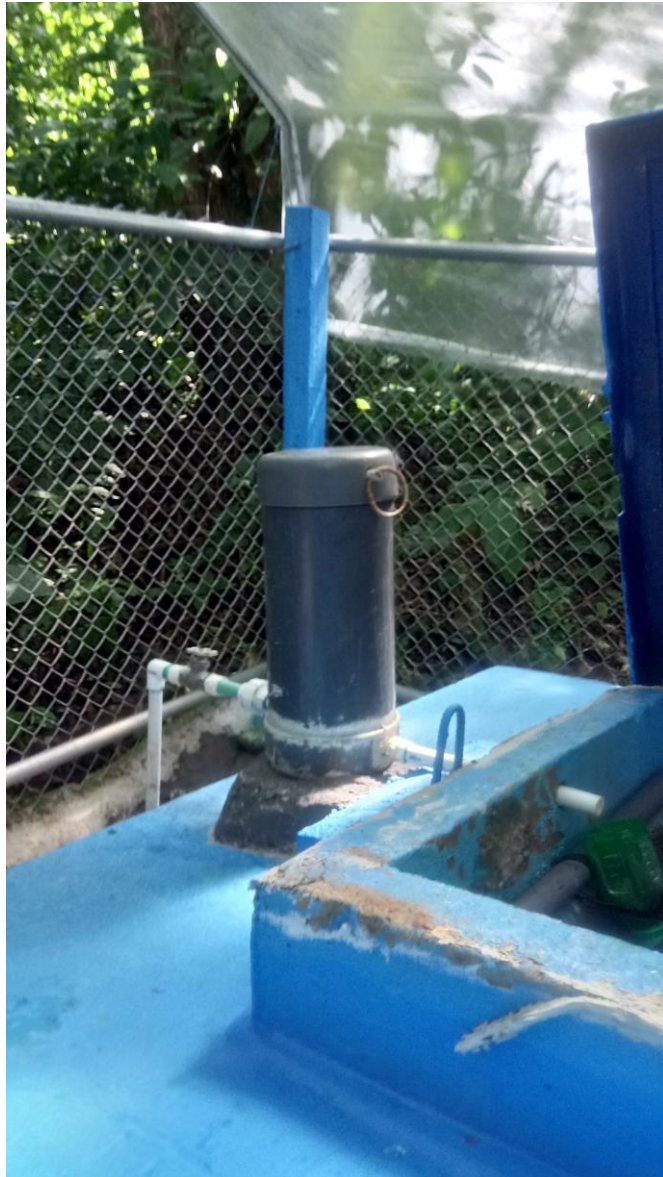
Figura 3: Vista del dispositivo de cloración.
