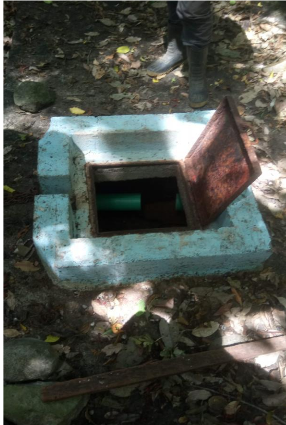
Figura 3: Tapa de metal oxidada.
