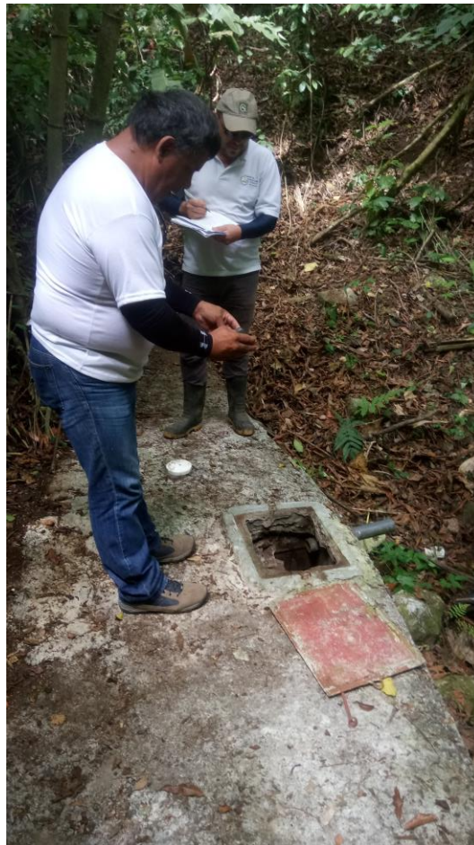
Figura 2: Captación Manantial Los Alpes.
